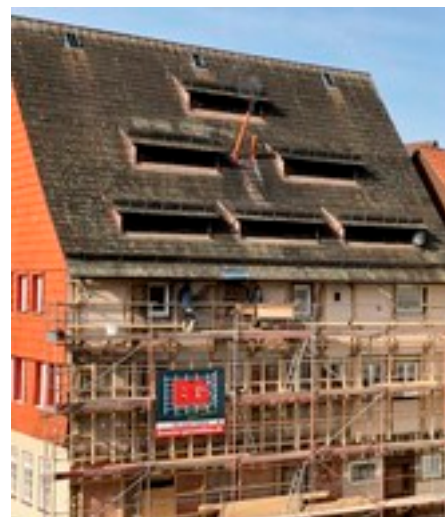
Am Pfarrhaus montierte Unterkonstruktion, an der später die Wärmedämmung und die Holzverschalung angebracht werden
